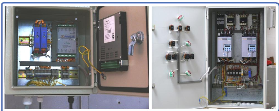
Рис. 4 - Пример шкафа программного управления и шкафа управления приводами
